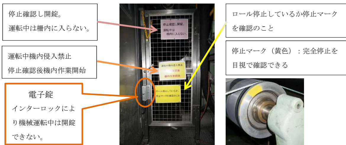
図 182 安全柵の扉に電子錠設置事例（左）停止マークの事例（右）
